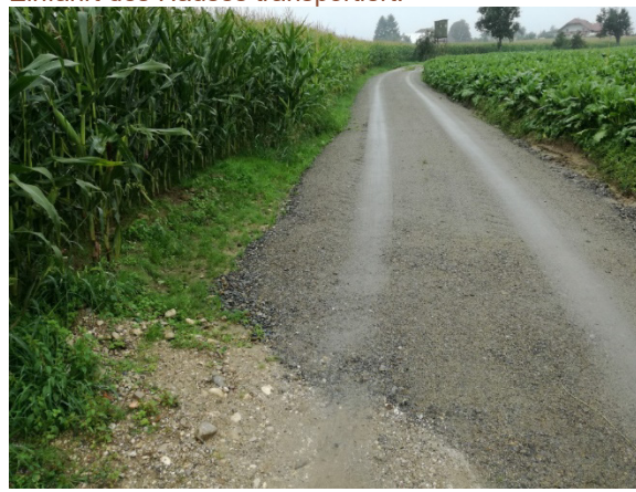
Abbildung 4: Die Gemeindestraße ist ca. 300 Meter lang und transportiert bei einem Starkniederschlag sehr viel Wasser.
