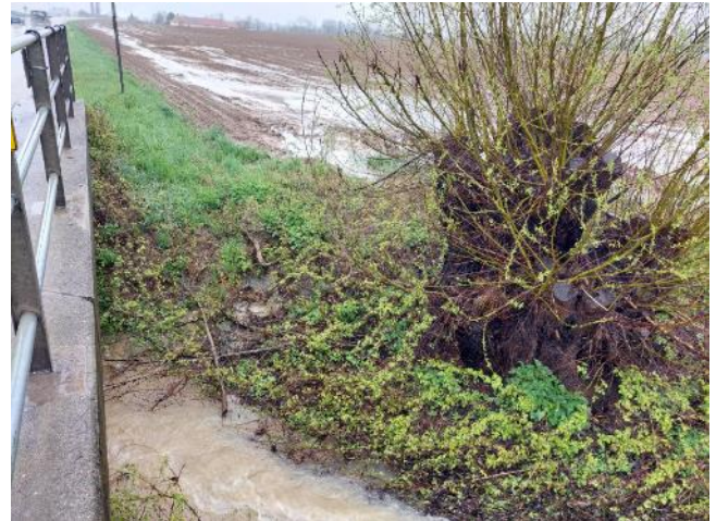
Erosionen waren auch im Jahr 2023 ein Thema, jedoch weniger als in den vergangenen Jahren.
