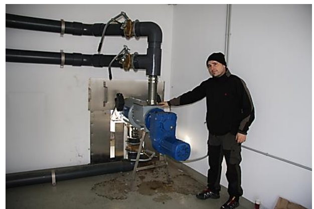
Fix installierter Gülleseparator
